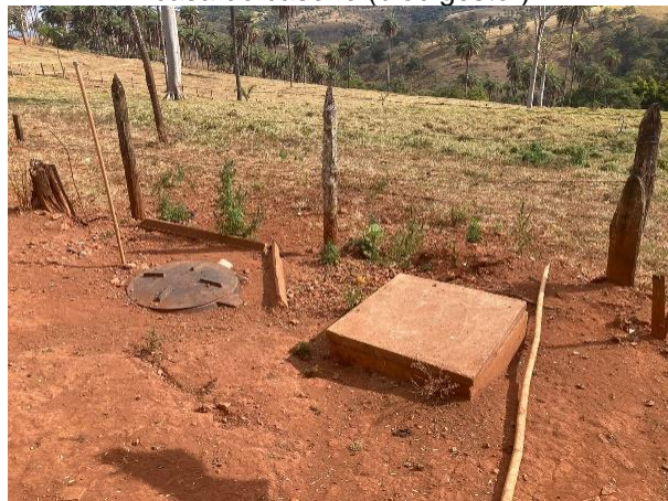
Figura 11: Sistema de tratamento de efluentes da casa do caseiro (bidigestor)
