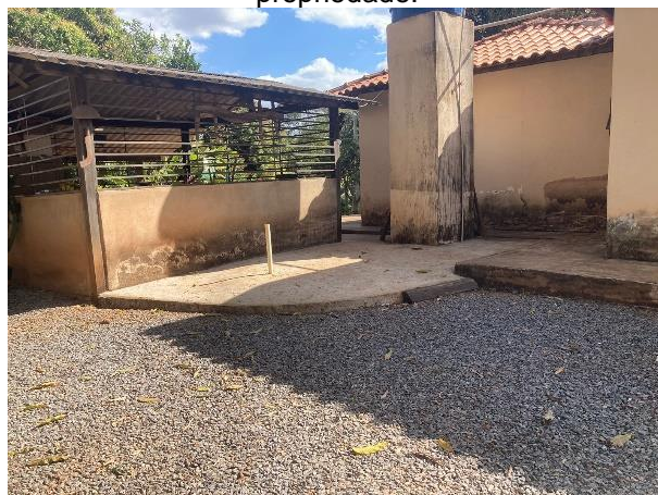
Figura 09: Vista da fossa negra na casa sede da propriedade.
